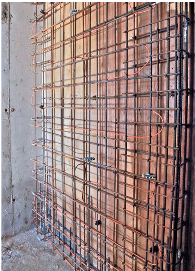
Kuva 21. BET-kaapeli asennettuna työmaalla. Lähde: Pistesarjat Oy, Heikki Hämäläinen.
