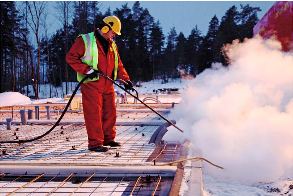
Kuva 27. Jäätä ja lunta voidaan poistaa esimerkiksi höyryn avulla. Kuva: Pistesarjat. Heikki Hämäläinen.
