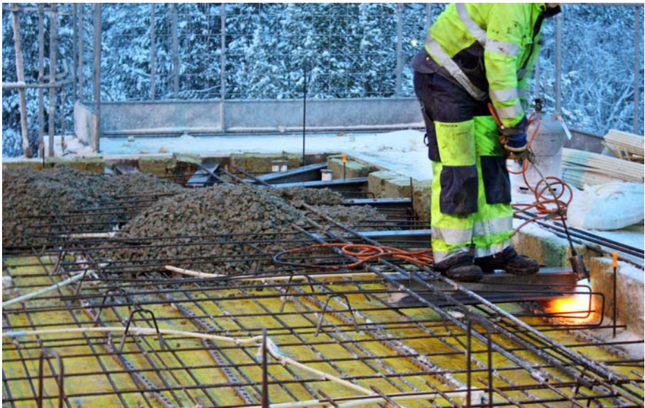
Kuva 17. Huolehditaan, että betonivalun alle ei jää lunta.
