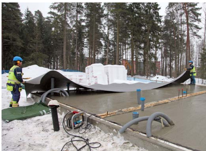
Kuva 19. Valu tulee suojata niin pian kuin mahdollista. Lämpöä eristävä peite asennetaan tiiviisti valua vasten ja tämän jälkeen rakenne suojataan vielä suojapeitteillä. Kuva: Pistesarja Oy, Heikki Hämäläinen.
